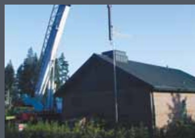
Grúas de servicio de bombas
